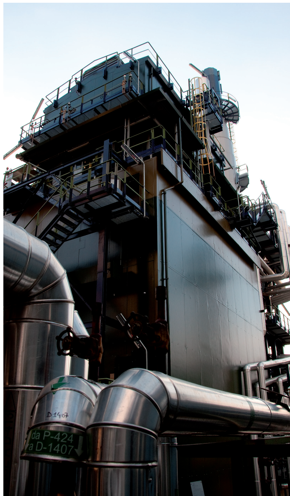
PARTICOLARE DEI FORNI DELL'IMPANTO RIVESTITI DA PANNELLI FONOASSORBENTI
