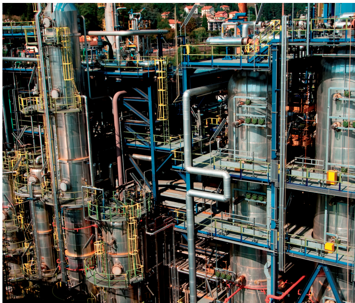
PARTICOLARE DEGLI IMPIANTI DI DISTILLAZIONE
