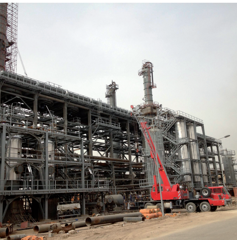
PROGETTO EPC PER MINISTRY OF OIL / MRC DAURA, BAGHDAD (IRAN). IMPIANTO DI ISOMERIZZAZIONE BENZINE SU LICENZA UOP. CAPACITÀ: 10.000 BPSD
