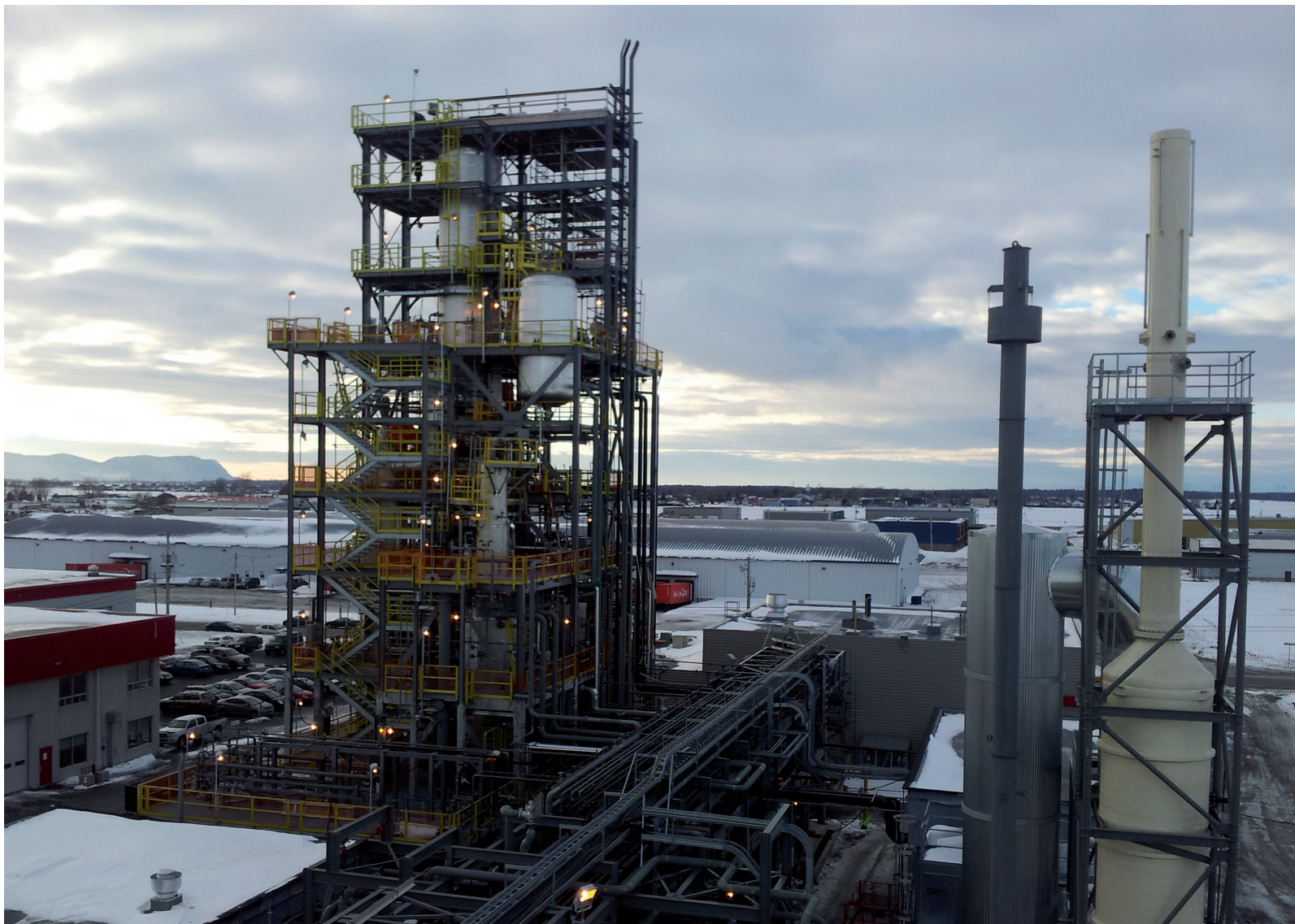
PROGETTO EPCM PER VEOLIA ES CANADA ST. HYACINTHE, QUEBEC. IMPIANTO DI TRATTAMENTO OLIO LUBRIFICANTE ESAUSTO PER LA PRODUZIONE DI V.G.O. (GASOLIO DA VUOTO). CAPACITÀ: 60.000 T/A
