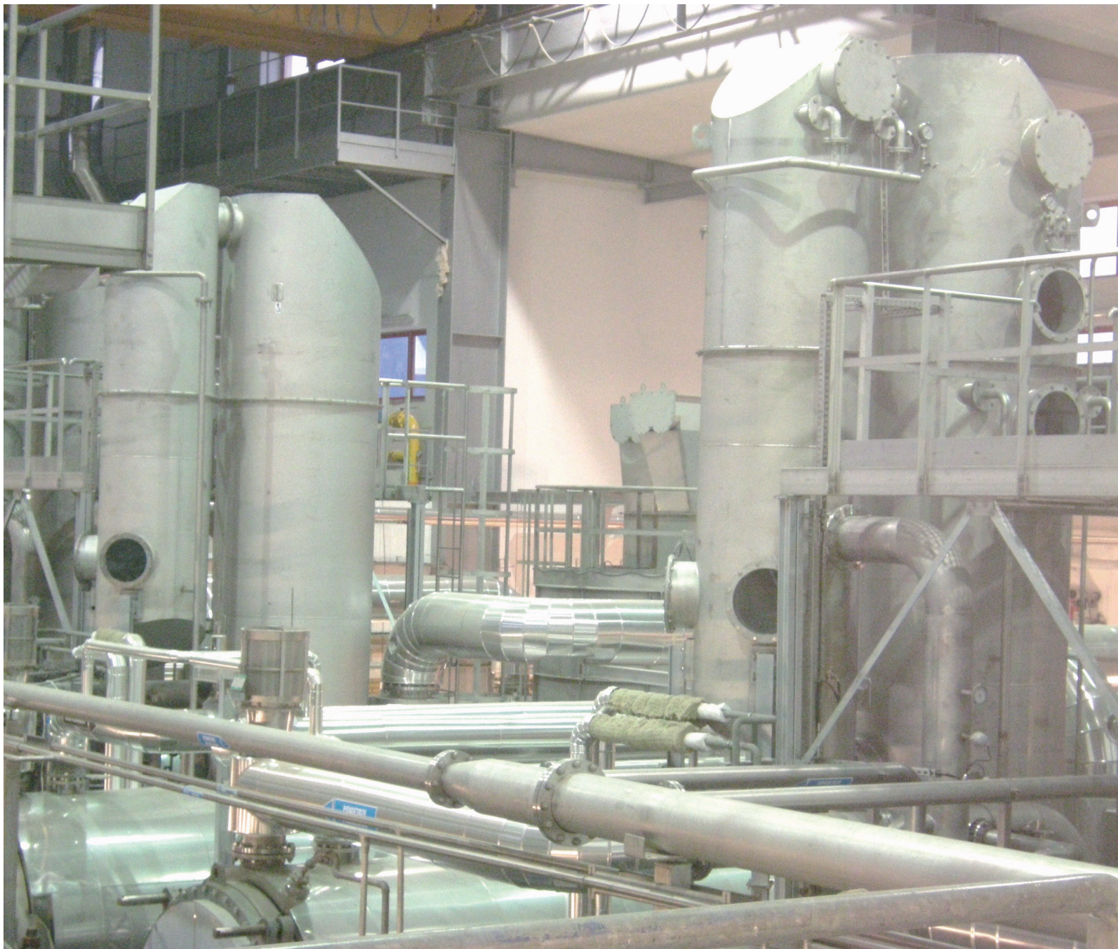
L'IMPIANTO ABBATTE LE POLVERI CONTENUTE NELL'ARIA E RECUPERA CALORE DALL'ARIA STESSA
