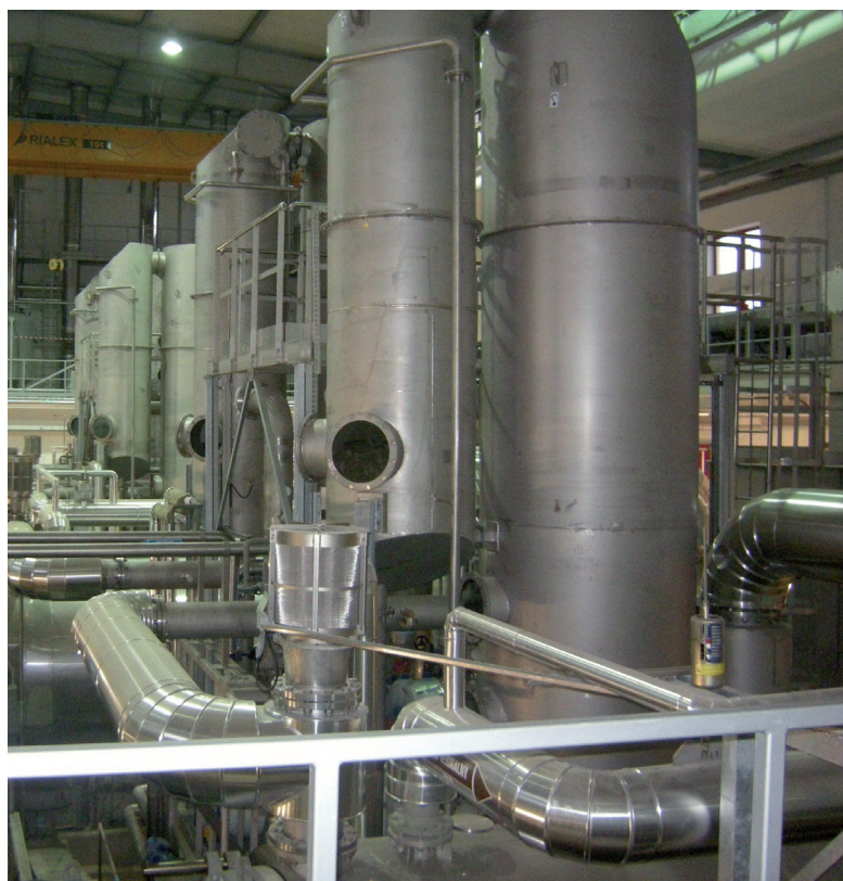
UN ALTRO PARTICOLARE DELL'IMPIANTO REALIZZATO DA AIR CLEAN IN POLONIA
